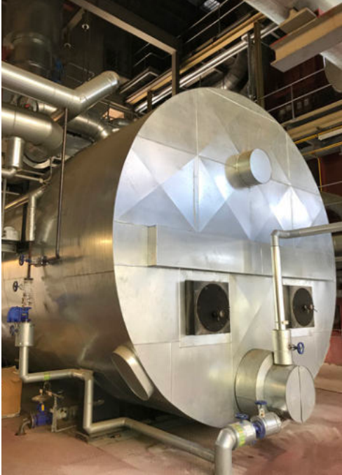
HKW Gießen Kältemaschine Bild: Stadtwerke Gießen AG
