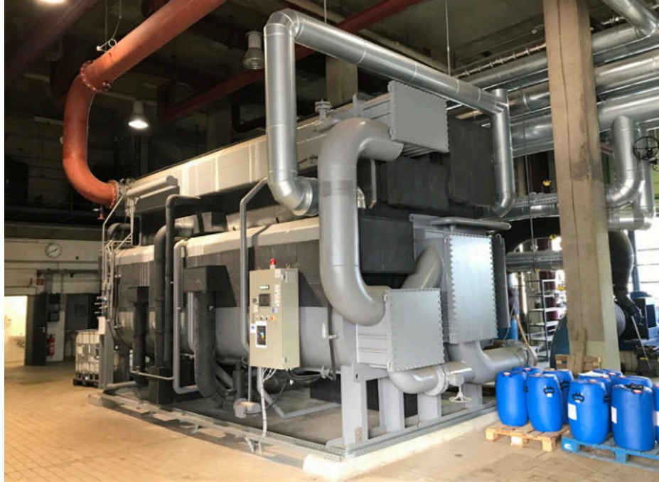
HKW Gießen Kältemaschine Bild: Stadtwerke Gießen AG
