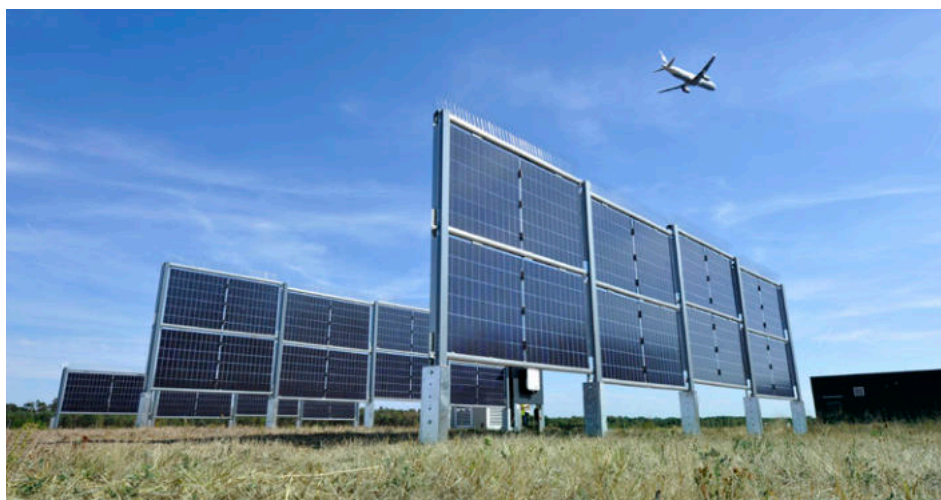
Fraport nimmt neuartige PV-Anlage am Bahnsystem in Betrieb, Bild: Fraport AG
