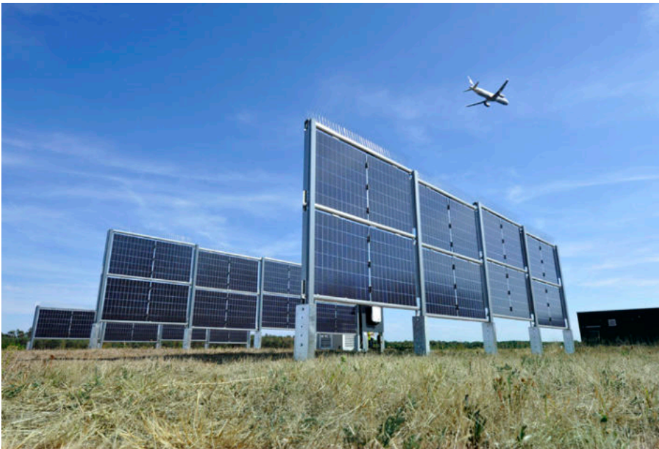
Fraport nimmt neuartige PV-Anlage am Bahnsystem in Betrieb, Bild: Fraport AG
